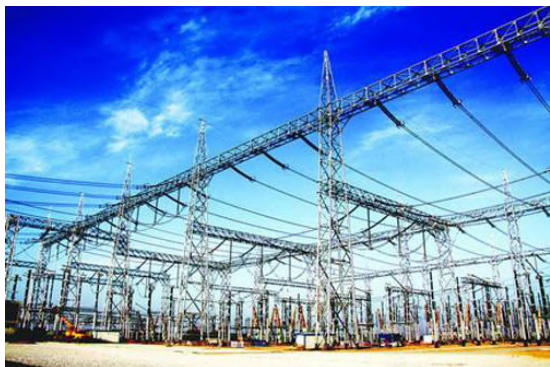
智能变电站控制系统
